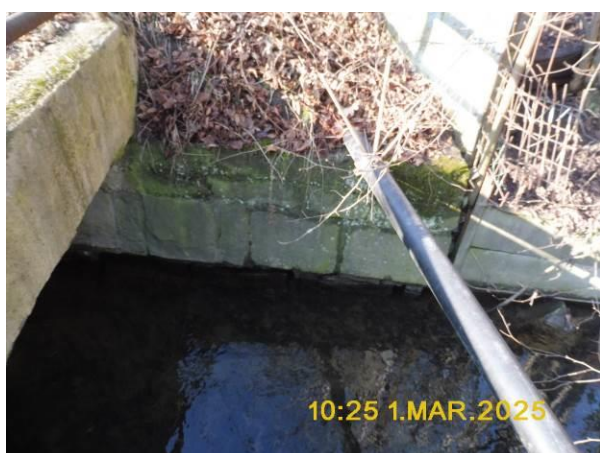
Rozvolněné kamenné bloky na LB
