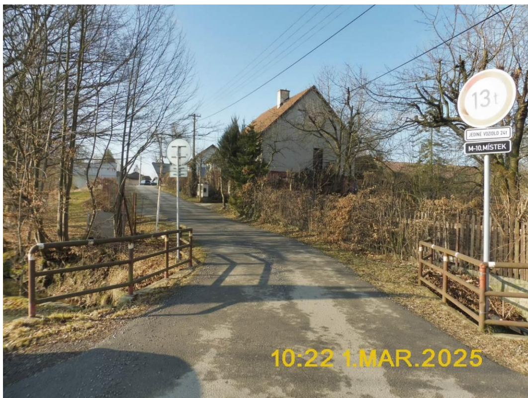
Pohled na most, zrezivělé nenormové zábradlí
