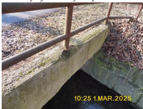
Degradovaná římsa mostu
