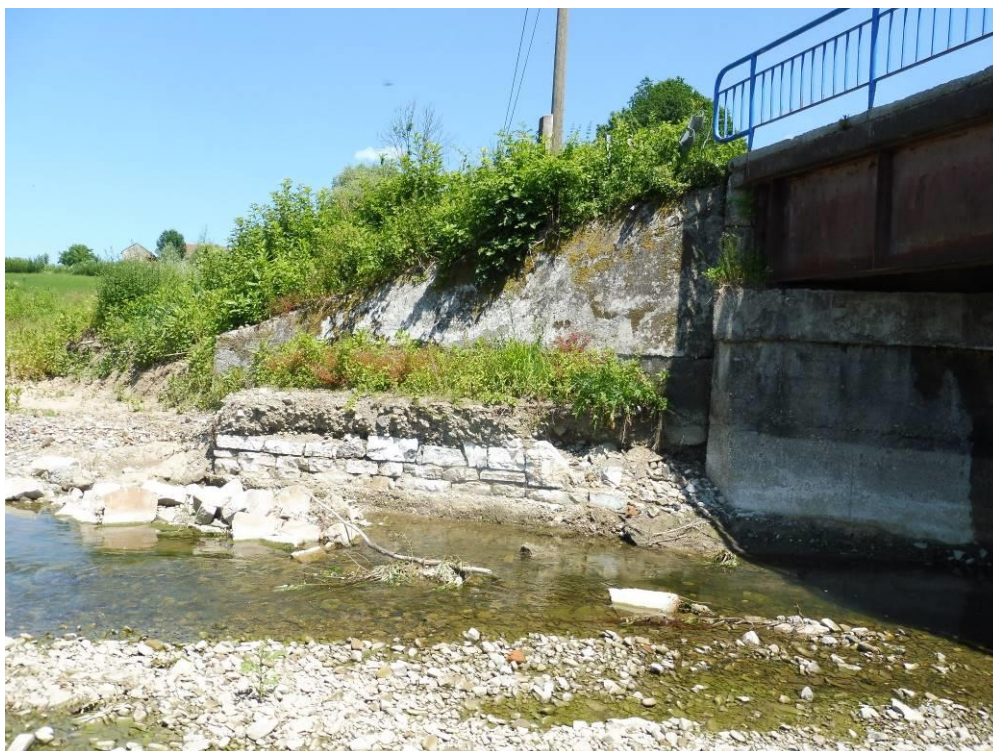
Částečně rozpadlá opěra původního mostu sloužící jako ochrana základové spáry pravého křídla opěry 1
