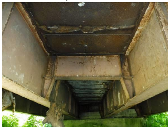
Stopy po zatékání na podhledu NK
