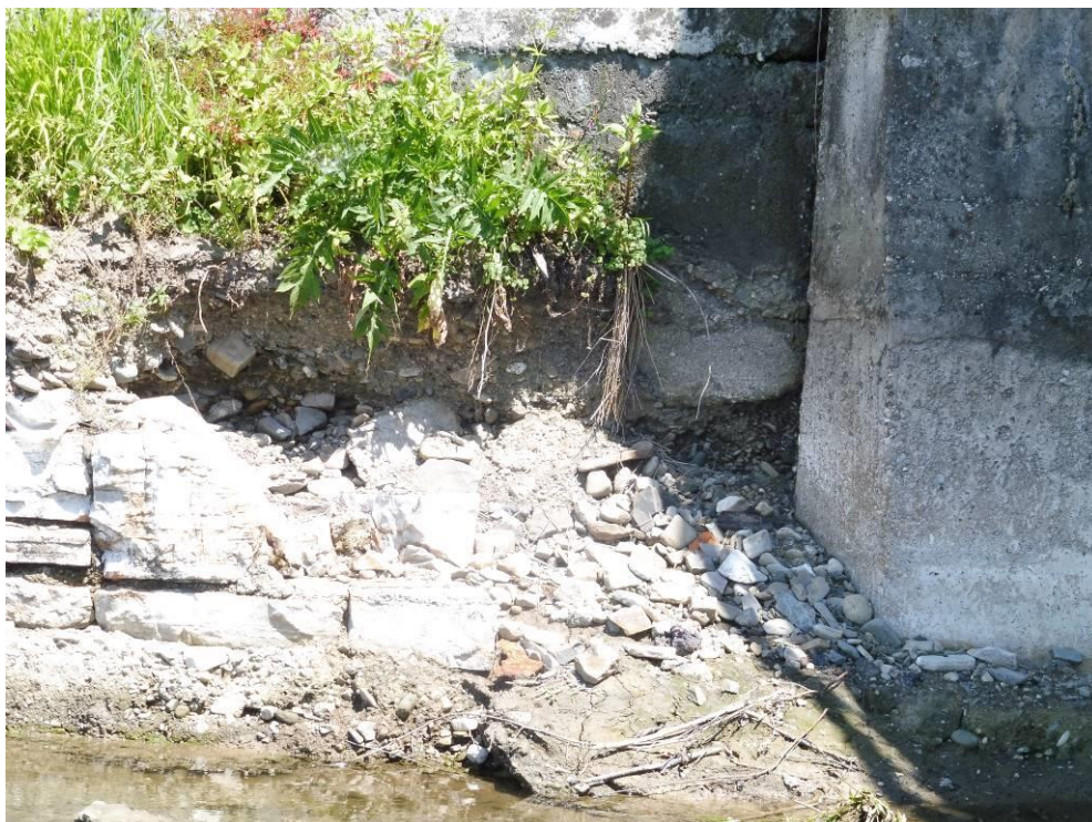
Odhalená základová spára pravého křídla opěry 1 – hrozící možnost podemletí a havárie křídla
