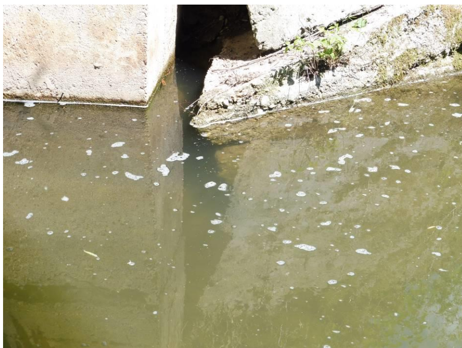
Průnik vody na bok opěry a do přechodové oblasti mostu
