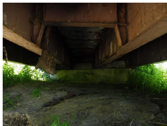
Podhled NK a pohled na zanesenou OP2
