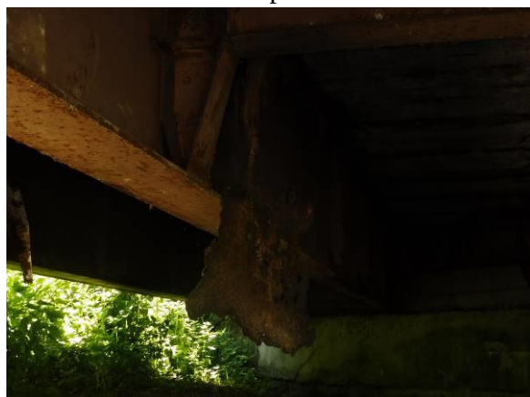
Podhled NK, odpadlé plechy bednění
