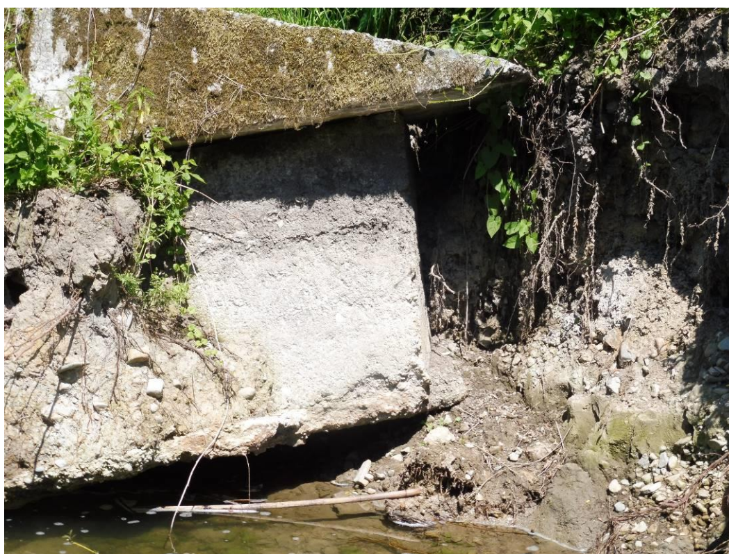
Horizontální posun dříku křídla proti základu křídla
