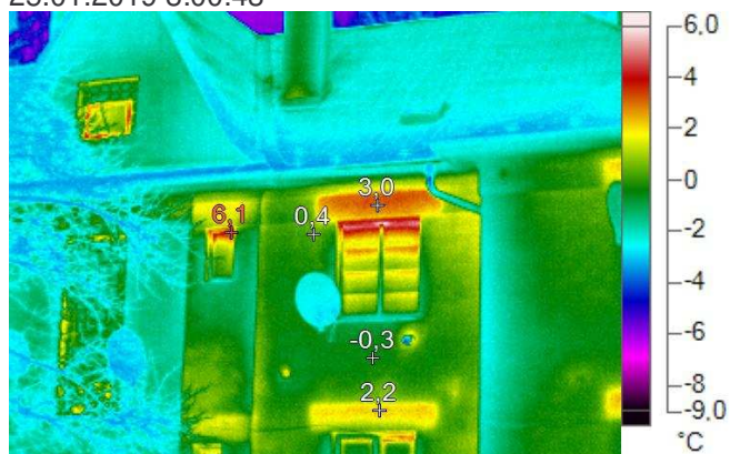
IR000440.IS2 byt č.8 kuchyň a koupelna – výrazné tepelné toky okny a nadkokenními překlady 25.01.2019 8:41:58
